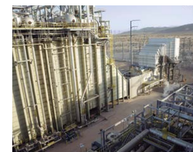
Termoeléctrica de Mexicali (TDM)
