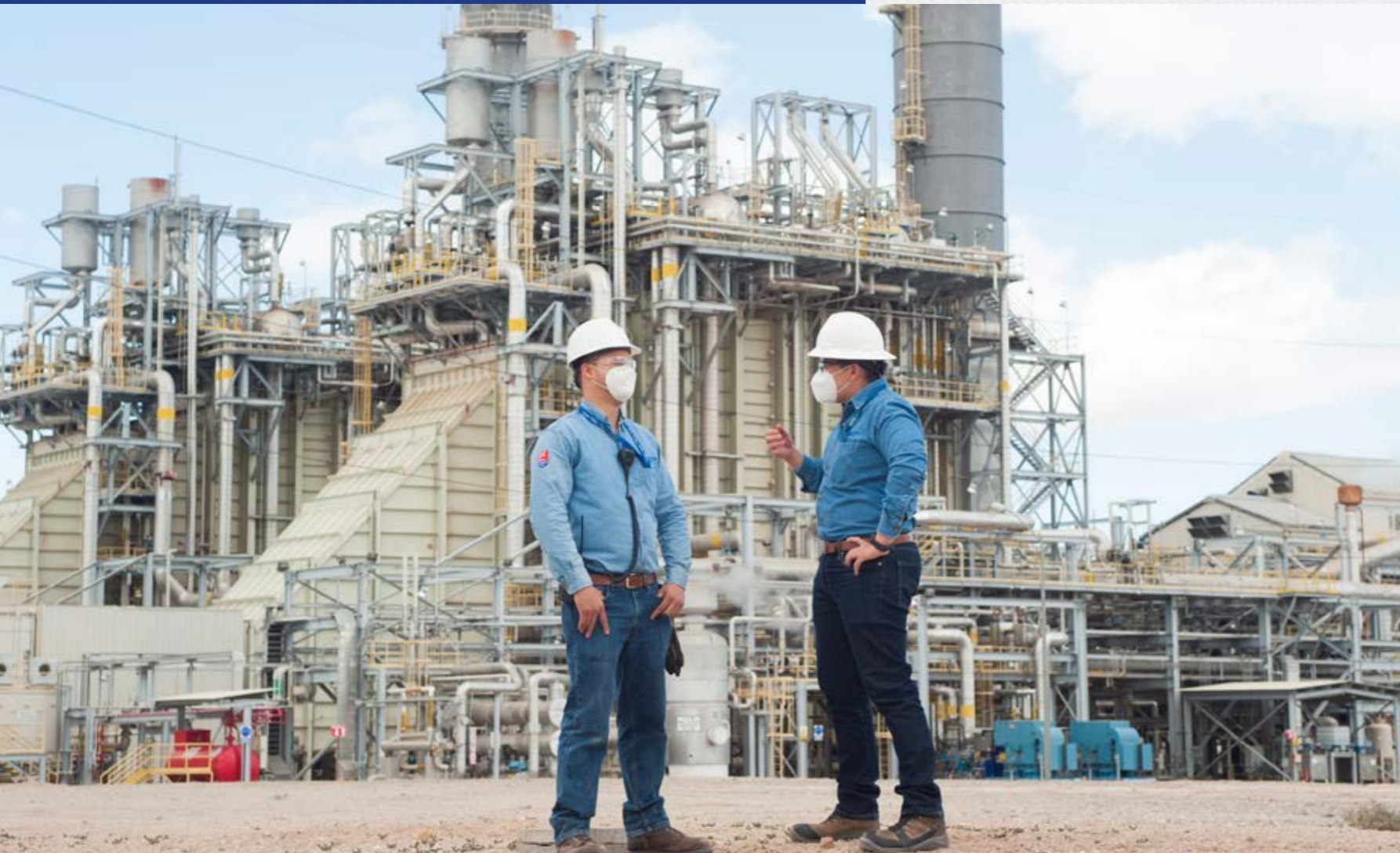
Termoeléctrica de Mexicali
