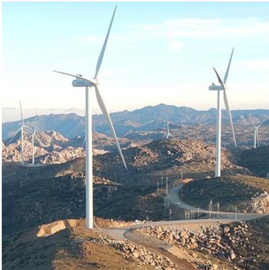
Energía Sierra Juárez 1 155 MW Wind Generation Facility La Rumorosa, Baja California
